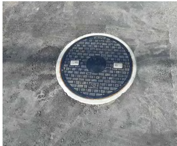
地下水位観測孔(マンホール)
