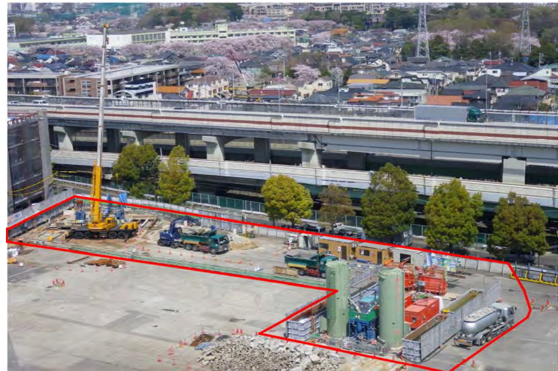
プラント等諸設備を含む全景
