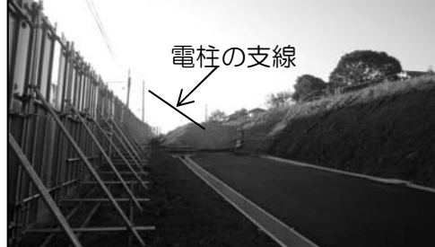
④工事用道路電柱の支線支障状況
