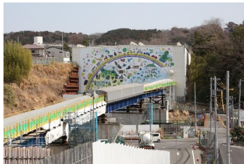
ベルトコンベア設置状況
