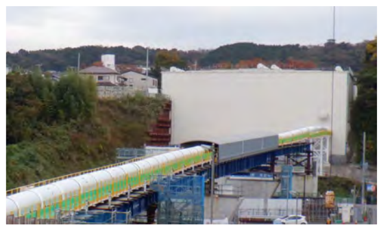
ベルトコンベア設置状況
