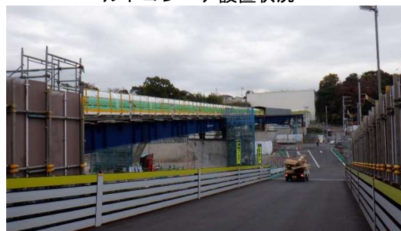
ベルトコンベア設置状況
