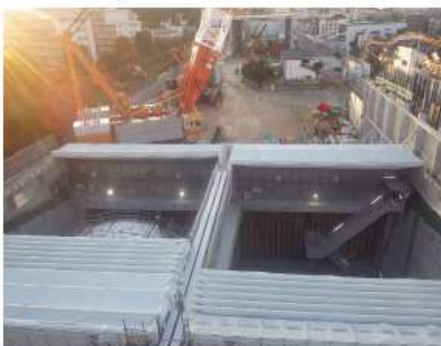
【参考】発進立坑での防音屋根設置完了写真 （※回転立坑は、5月末に設置完了予定）
