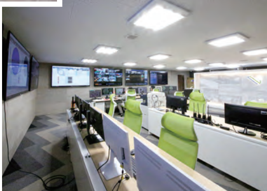
シールドマシンのコントロールルーム
